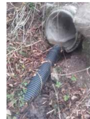
Turjak-iztok iz greznice speljan v propust
